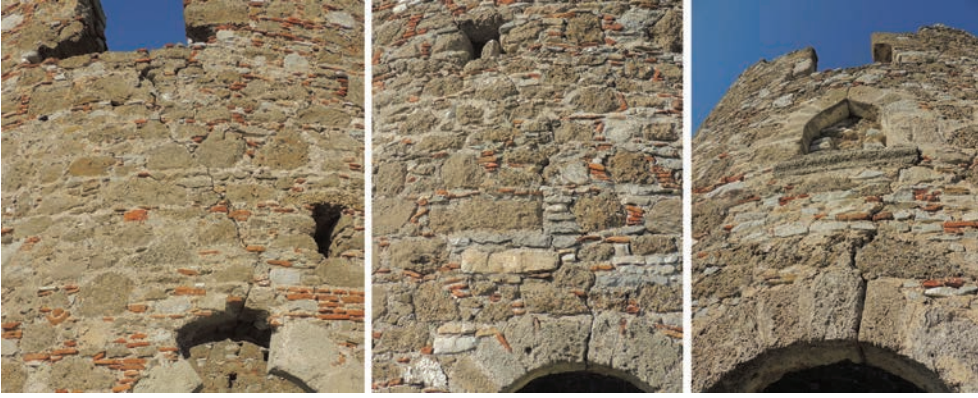
SOLDA 2, 3 ve 4 nolu yel değirmeni yapılarının duvarlarında meydana gelen düşey ayrılmalar (E. Gökaltun arşivi) (Resim 9)
